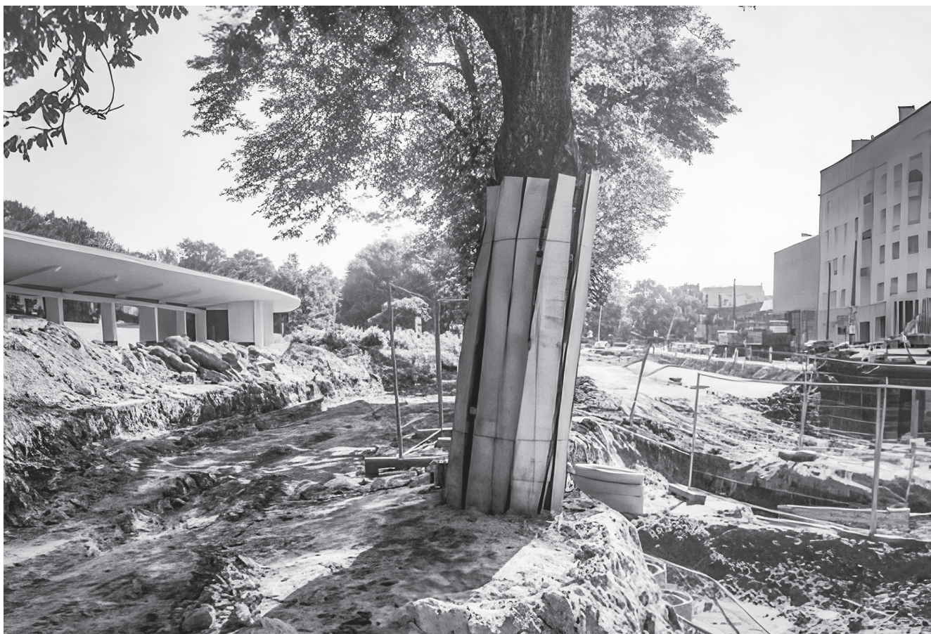
Żywy kasztanowiec z uszkodzonym systemem korzeniowym w trakcie remontu ul. Północnej
